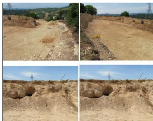
شکل (۱): تخریب گورستان تاریخی ولَم در آبان ۱۳۹۹ در اثر عملیات عمرانی راه‌سازی
