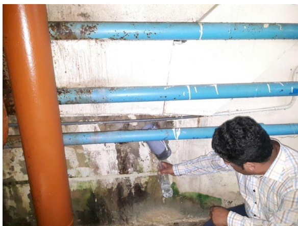
شکل (۴) محل نمونه‌برداری آب از بدنه سد شهید عباسپور و مشاهده خوردگی لوله‌های بکار رفته در بدنه سد به‌واسطه و ریختن آب از بدنه سطح بر روی لوله‌ها.
